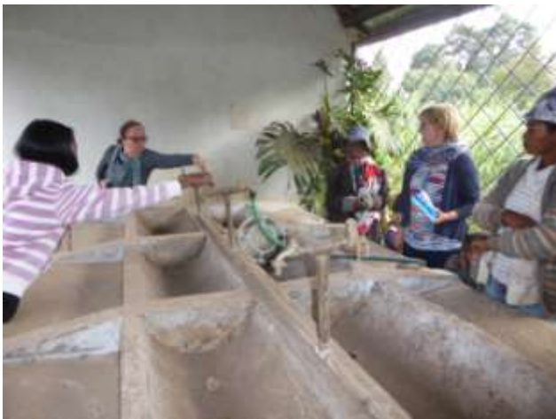
Contrôle des robinets (compteur fermé)
